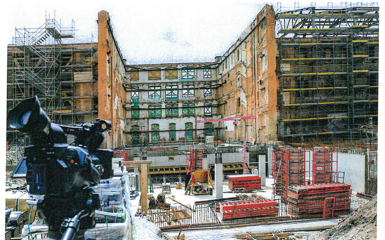
Der Mittelteil des Gebäudes musste wegen seiner häufigen Umnutzung, des langen Leerstands und der maroden Bausubstanz entkernt werden
